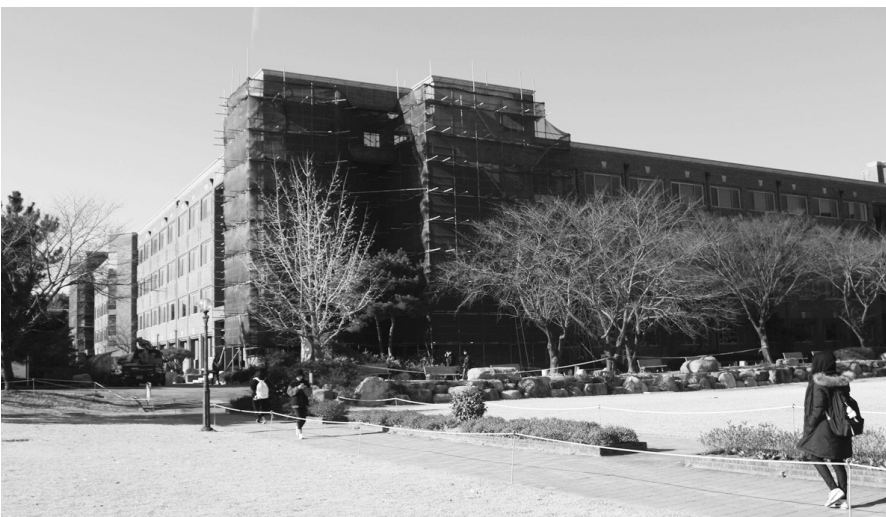
외벽이 붕괴된 한동대 느헤미야홀, 더 이상 붕괴되지 않게 구조물을 설치했다.
